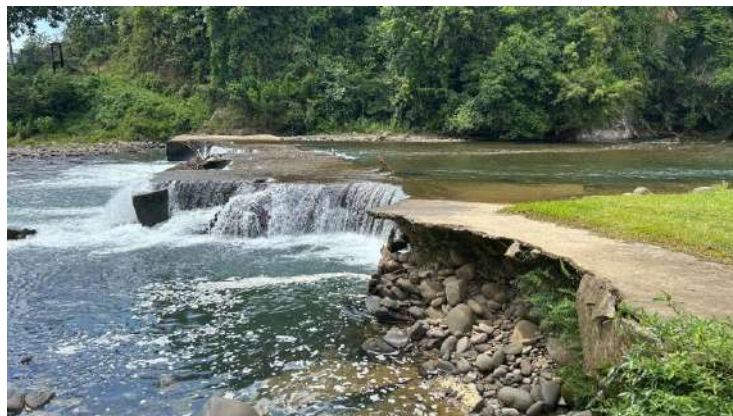
Rajah 2: Keadaan jambatan rendah (low level crossing) yang mengalami hakisan dan tidak selamat digunakan oleh penduduk Kg Lubok Sumber: Gambar diambil oleh Mc Jeanet pada 15 Mac 2025
